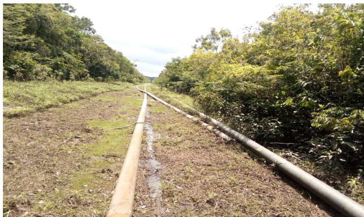
Foto tomada por monitor ambiental de ACODECOSPAT Ander Ordoñez de las tuberías que son parte del Oleoducto Corrientes-Saramuro (2019).
